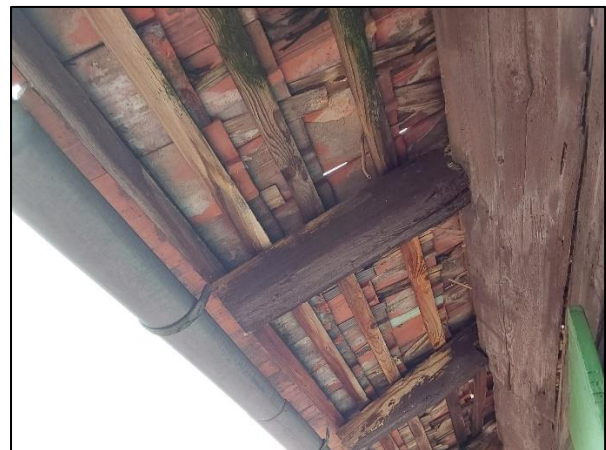
Abb. 7: Traufe von unten mit Spalten und offenen Holzbalken
